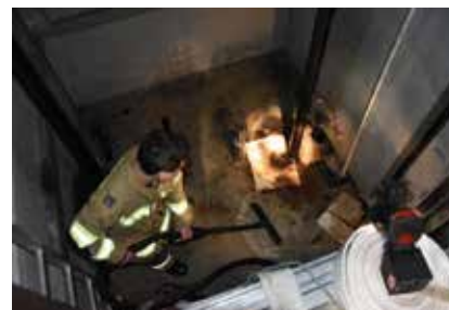
Ein Mitglied der FF Abtenau beim Auspumpen eines Liftschachtes
