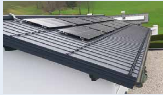
PV-Anlage VS Voglau
